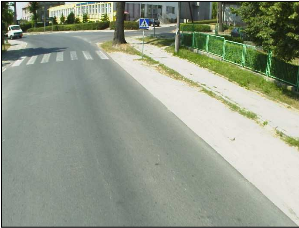
lewostronny chodnik z pasem zieleni i poboczem wykorzystywany jako miejsce do parkowania samochodów
